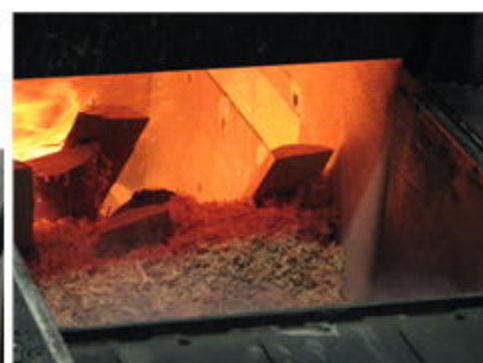
製材の端材を燃焼させて加温しているバイオマスボイラーの投入口（上）
