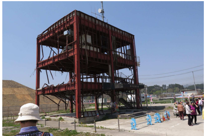
骨格だけ残った旧防災センター
