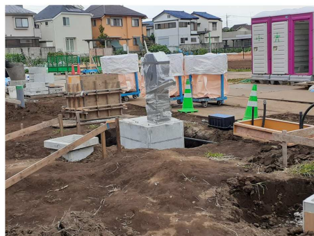
中央は井戸(圃場は中央通路が出来上がっている程度だが、井戸はすでに水を汲み上げ可能)
